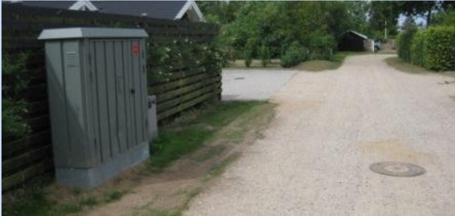
Bregnevej - dæksel pumpestation \varnothing 70 cm midt på vejen. Skelbrønd dæksel \varnothing 50cm (ikke afbildet her)
