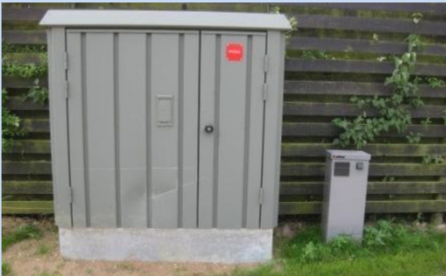
Bregnevej - til venstre teknikskab til pumpestation: h 155cm x b 170cm x d 52cm til højre Strømskab SEAS-NVE: h 75cm x b 34cm x d 21cm
